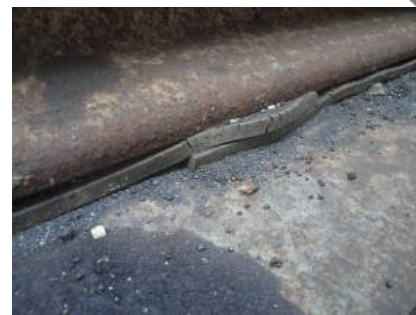
Kiskon alustojen virheellinen asennus.
