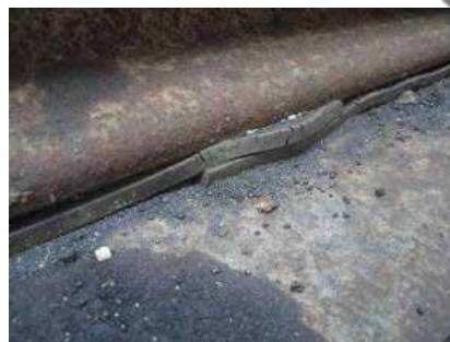
A base do trilho não está instalada corretamente.
