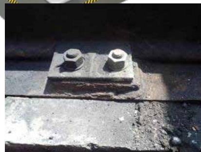
As soldas do grampo de trilho estão começando a corroer.
