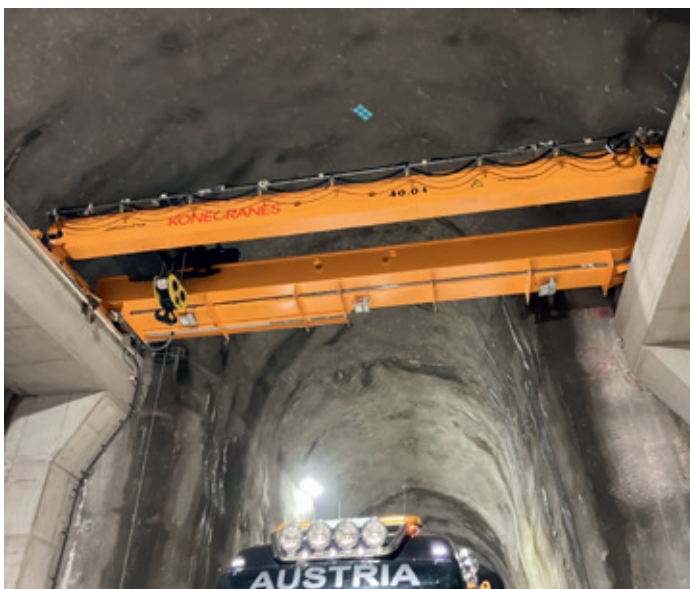
40t CXT-Zweitträger-Brückenkran in der Apparatekammer.
