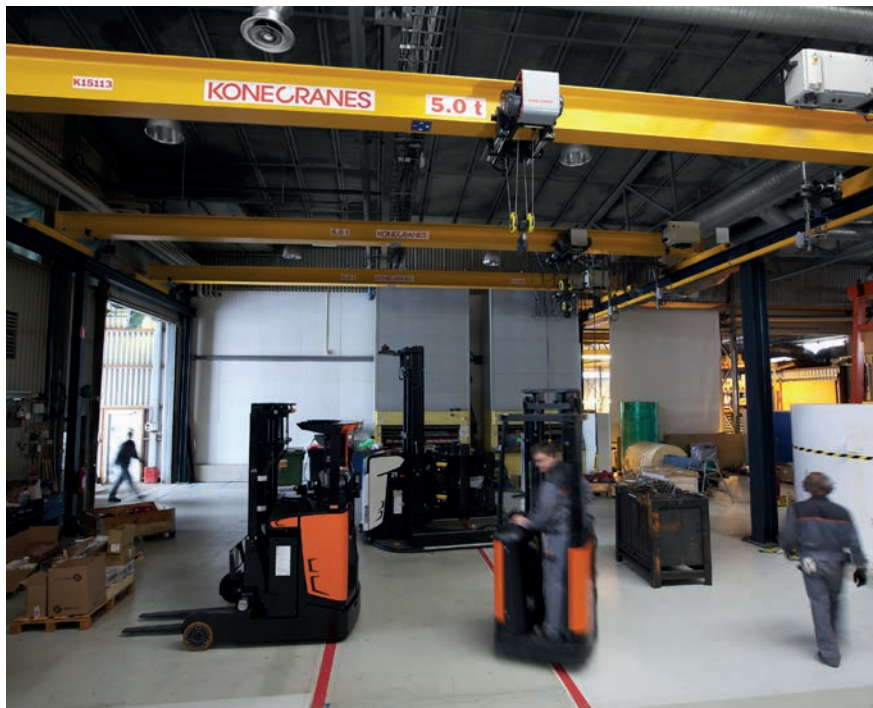
Dvounosíkový mostový jeřáb po modernizaci ve výrobní hale.
